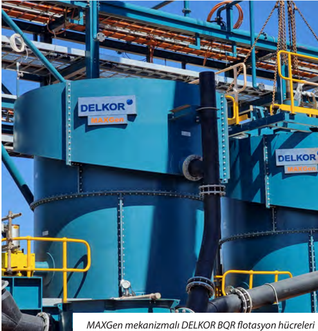
MAXGen mekanizmalı DELKOR BQR flotasyon hücreleri
